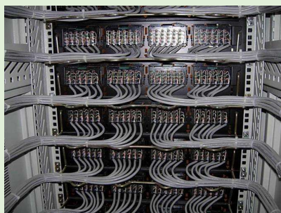
弱电箱相关安装后
